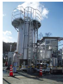
図2 実証設備外観
